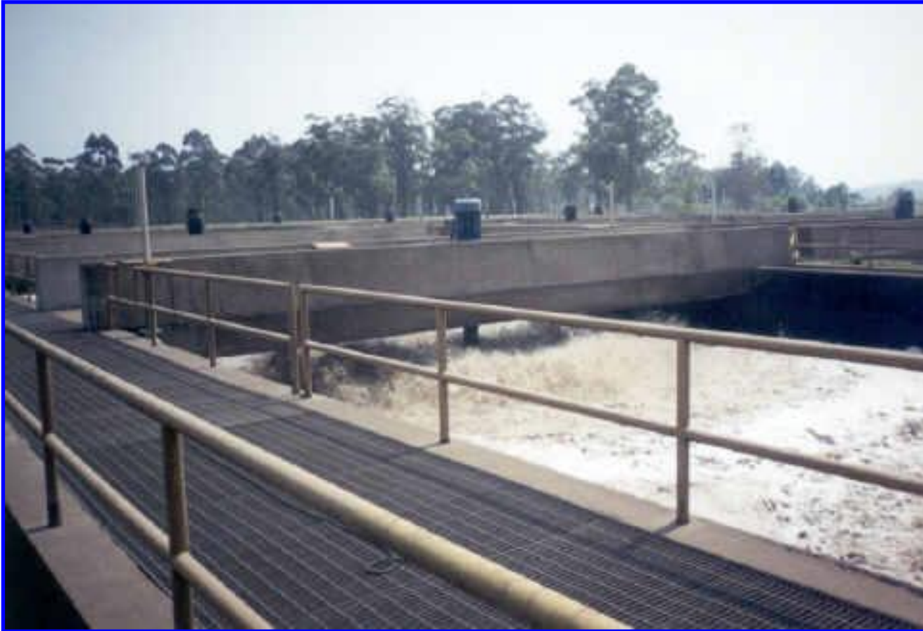
Tanque de Aeração
