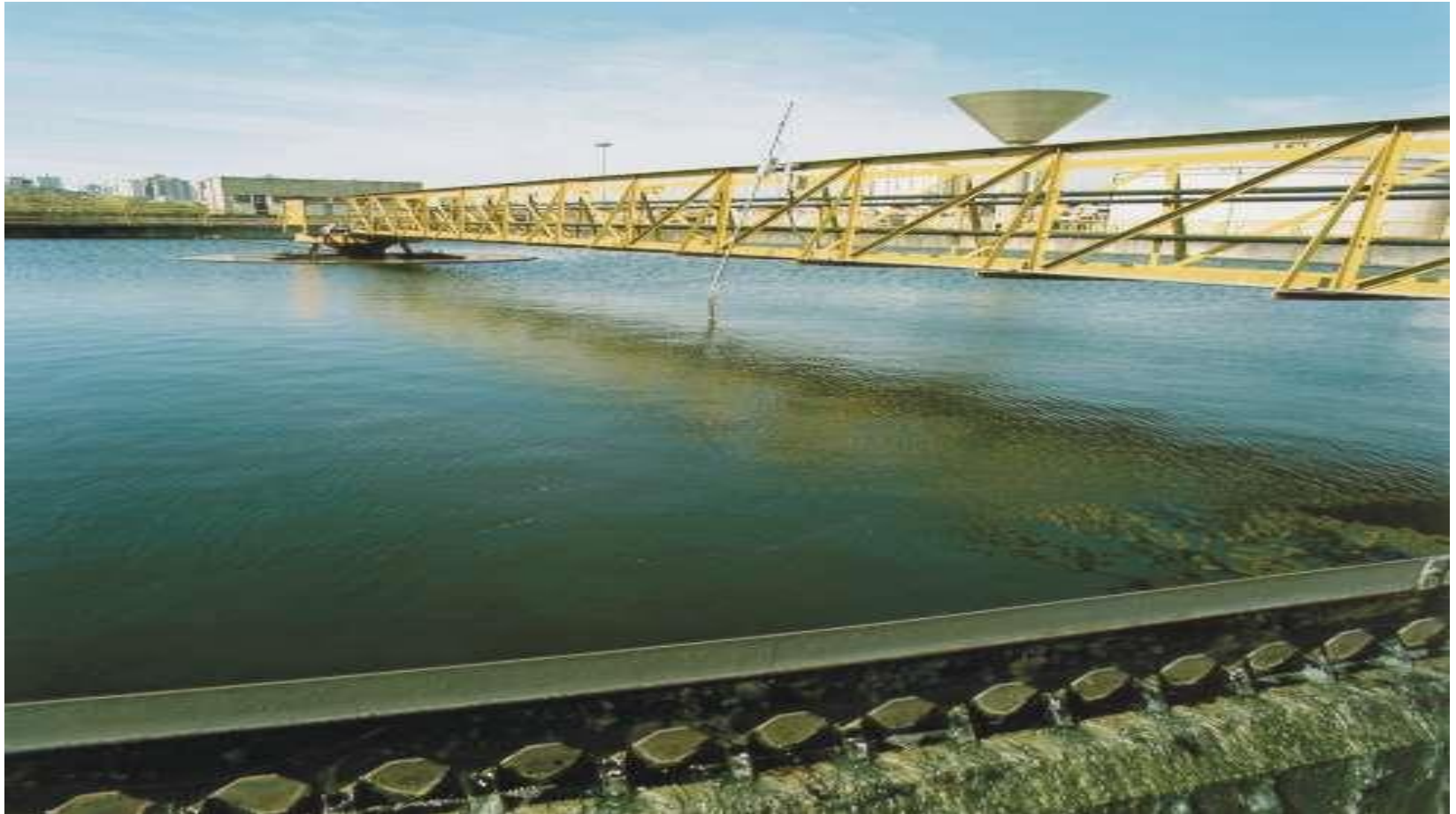
Decantador secundário de sistema de lodo ativado
