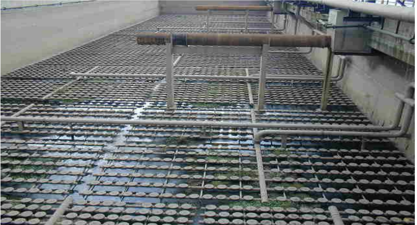
Tanque de aeração com sistema de ar difuso.
