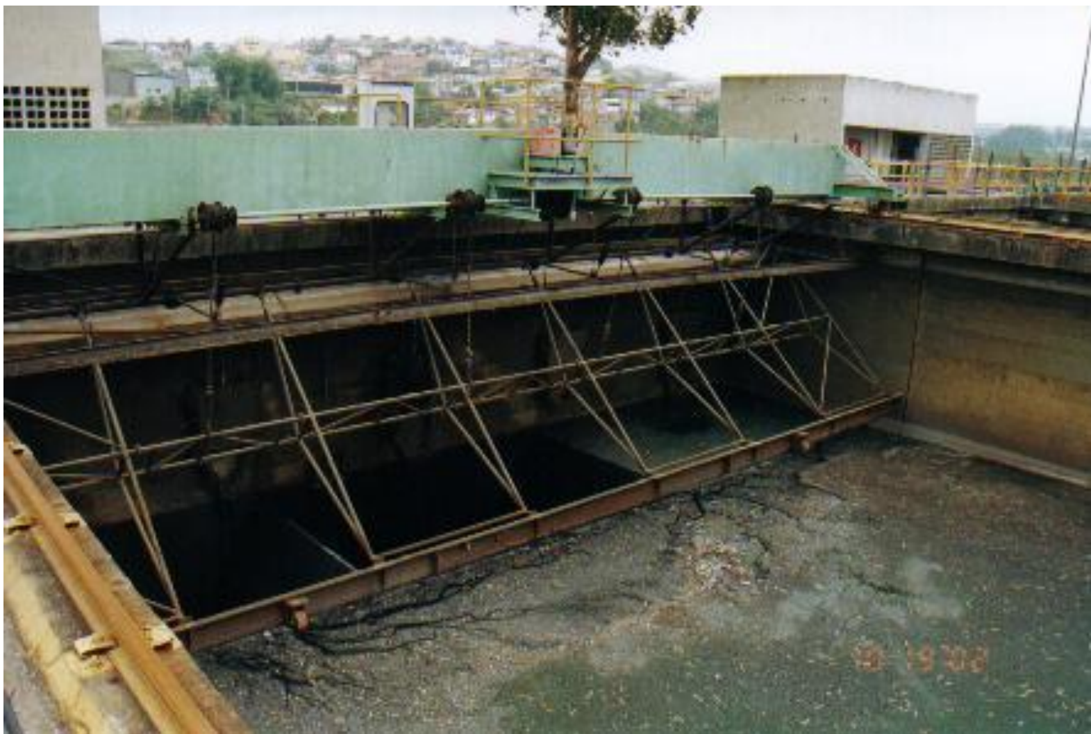
Decantador primário seção retangular da ETE Barueri/SP (SABESP)
