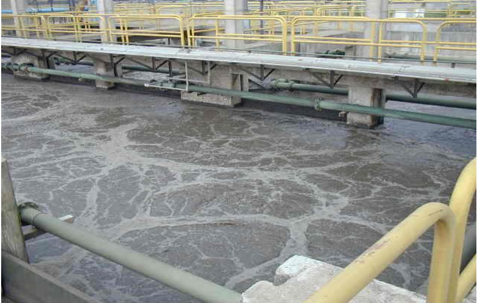
Tanque de aeração por ar difuso em operação
